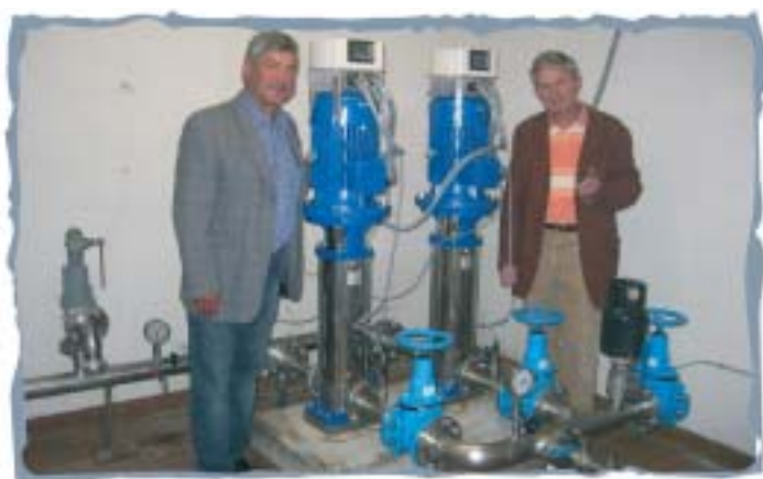
Obmann des Bauausschusses GR Richard Faschinger und Betriebsleiter AL Ernst Pretis bei Inbetriebnahme der neuen Pumpen in der Hebeanlage Eiswirt
